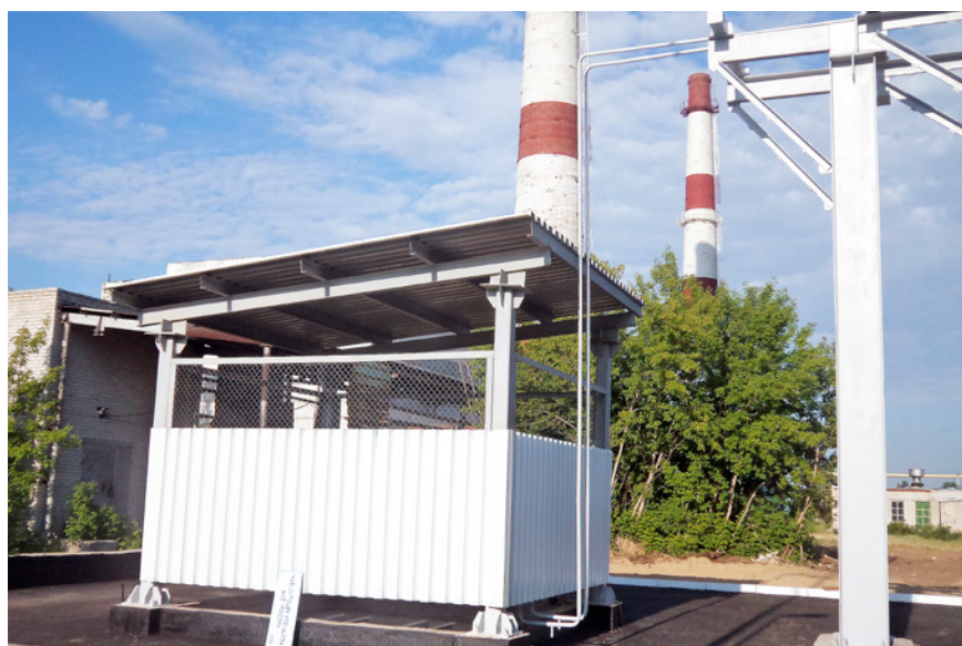
Станции перекачки циклопентана
