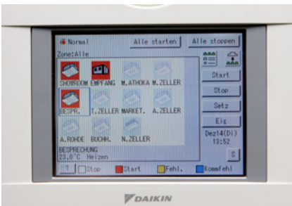
Важная часть построения энергоэффективного здания — система автоматизации и управления
