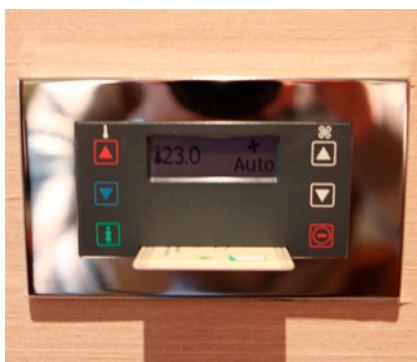
У гостя — удобный пульт климат-контроля, у инженеров тоже все автоматизировано
