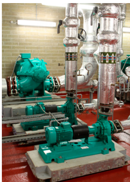
Все насосы современных высокопроизводительных зданий оснащены частотным регулятором
