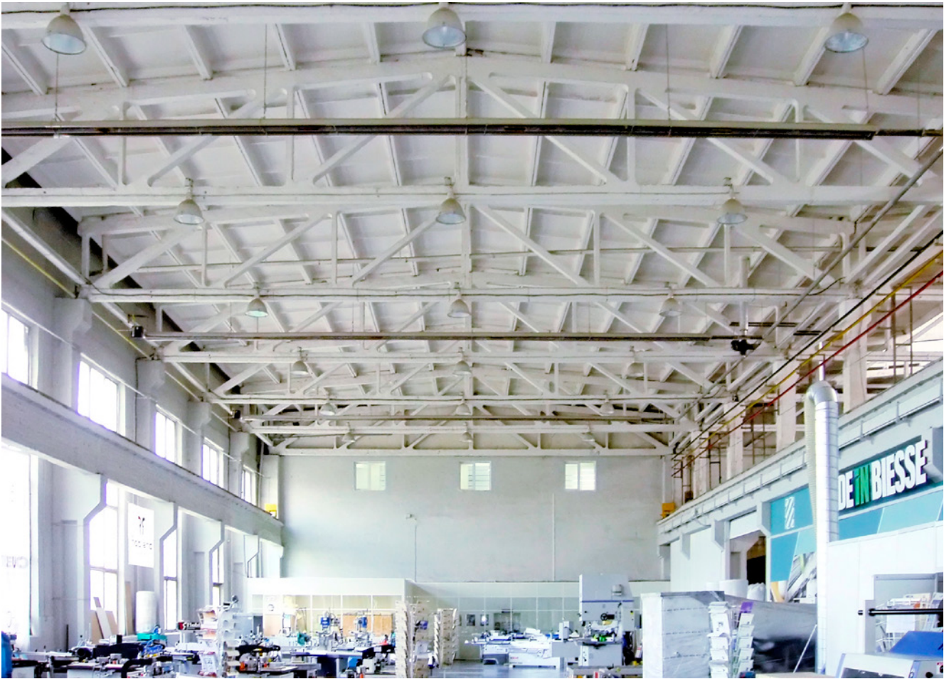
Инфракрасная газовая система отопления в производственном цехе
