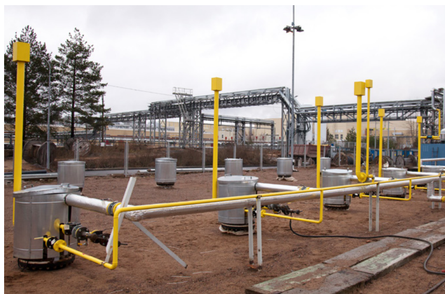
Резервуарный парк системы резервного топлива «пропан-эир»
