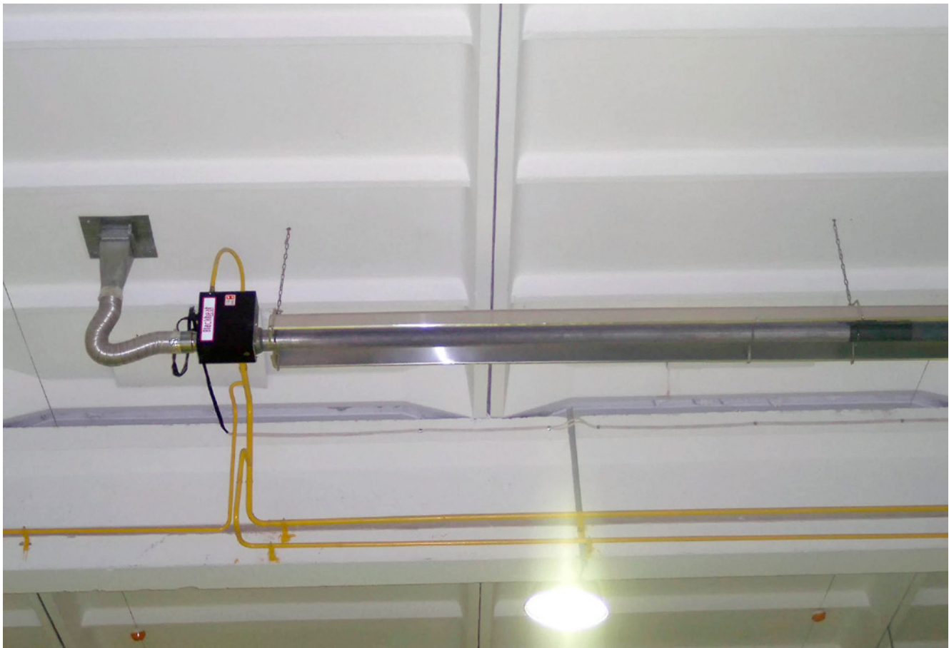
Газовые ИК-системы — размещение на потолочных конструкциях
