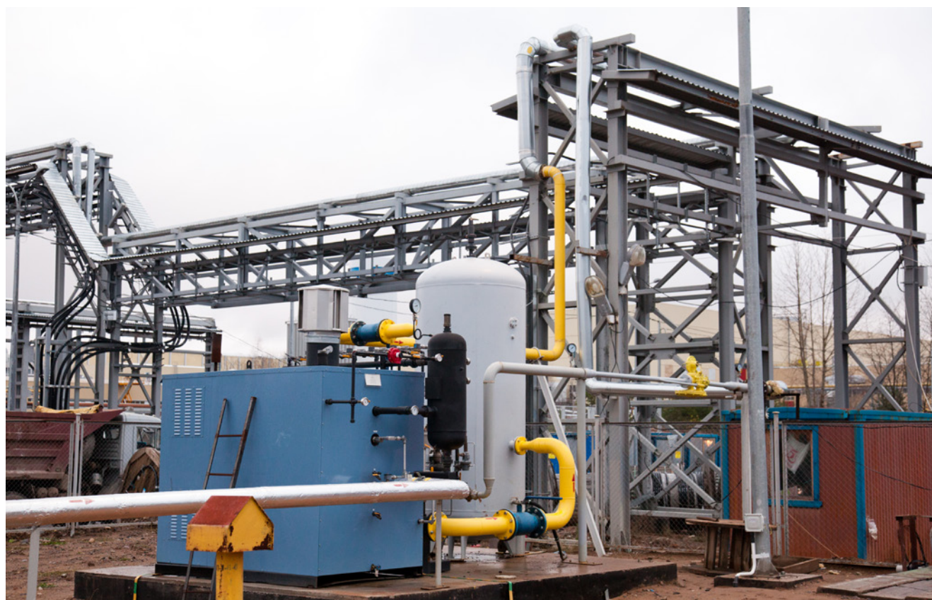
Испарительно-смесительная установка системы резервного топлива «Пропан-Эйр»
